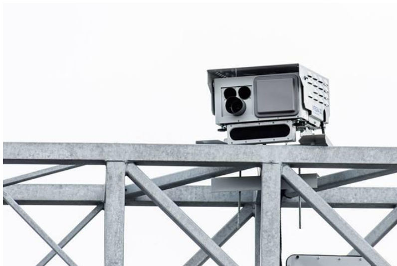
Рис.6. Общий вид стационарного видеорегистратора
